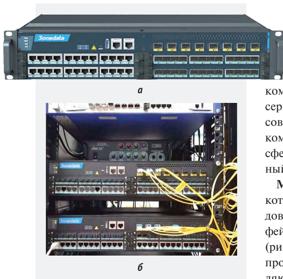
Рис. 6. Коммутатор Zonedata ICS5556 уровня L3 для ядра сети: внешний вид (а); установка на объекте (б)
